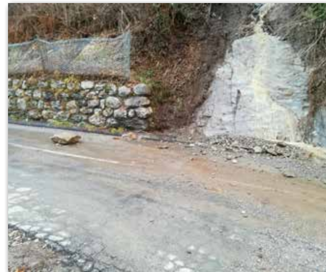
Le Pont - éboulement en janvier 2017
